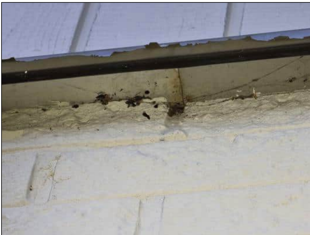
Kuva 17. Hämähäkinseitteihin tarttuneita lepakonpapanoita Koivurannantie 8:n rakennuksen päädyssä. RK.
